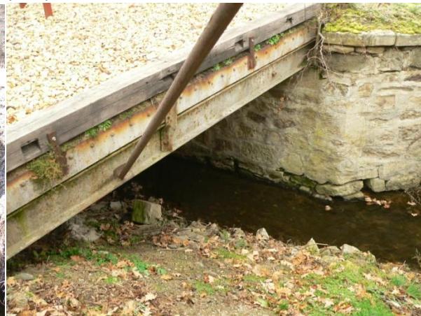
Obr.42 - Částečně zanesený starý silniční mostek
