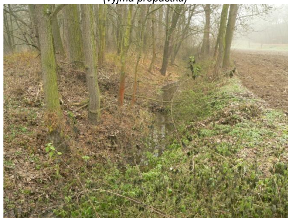
Obr.48 - Zanesené a zarostlé odpadní koryto nad soutokem
