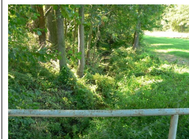
Obr.23 - Zarostlý odpadní kanál od bezpečnostního přelivu
